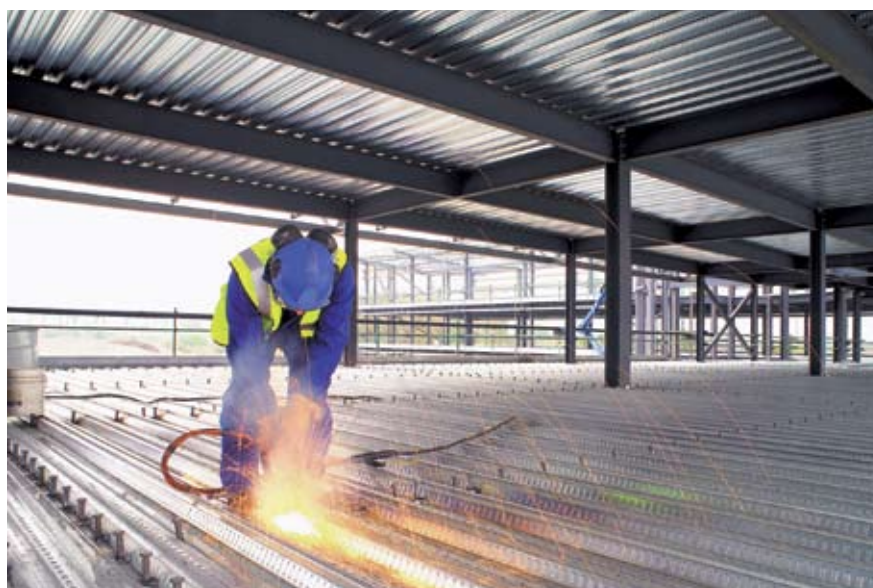
Figure 1-15 : Ancrage procuré par des goujons connecteurs soudés au travers de la tôle
